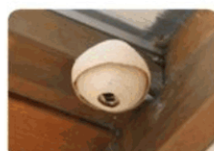
NID DE FRELON ASIATIQUE SOUS DES RIVES DE TOITURES
